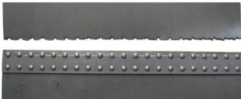
Рис. 3. Разрушение продольного стыка панелей фюзеляжа, поврежденного многоочаговыми трещинами в результате растяжения
